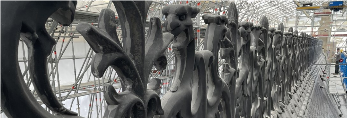
Toiture et crêtes de faîtage de l'aile des Preuses - Château de Pierrefonds
